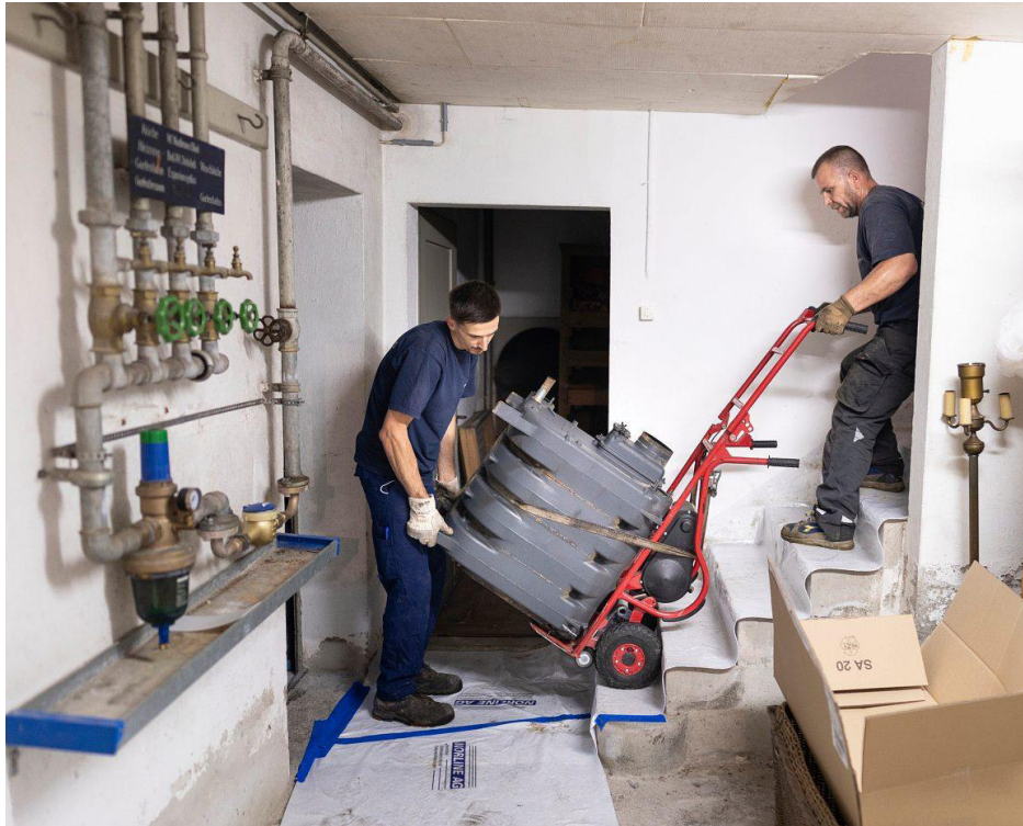
Abtransport des alten Ölheizkessels: Nun soll eine Erdwärmepumpe eingebaut werden. Foto: Gaëtan Bally (Keystone)
